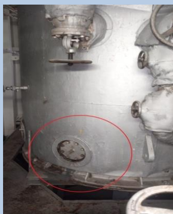
Εικόνα 1: Θυρίδα ελέγχου λέβητα
