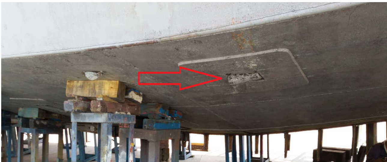
Εικόνα 18: Η περιοχή του περιβλήματος πυθμένα περίξ του νομέα όπου δημιουργήθηκε το ρήγμα, μετά την αποκατάστασή του.
