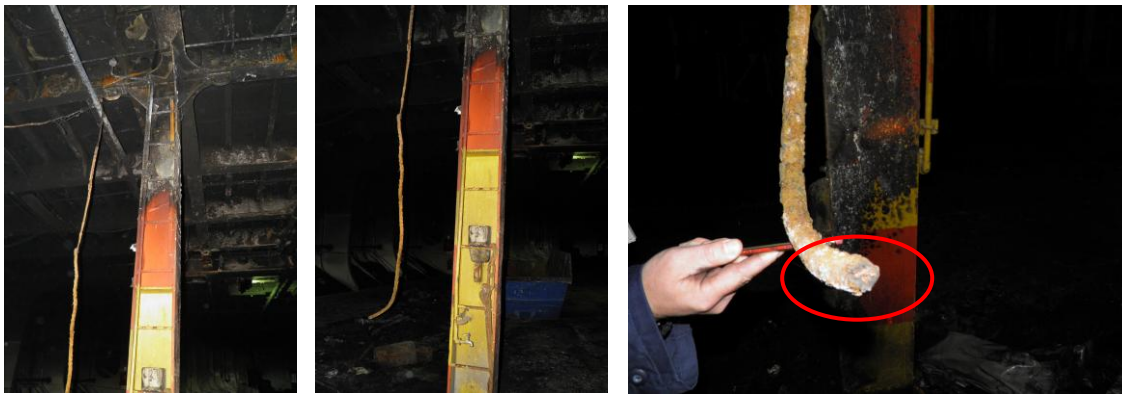
Η πυρμναία πλευρά του στύλου μεταξύ των νομέων 219-221 και το κομμένο καλώδιο.
