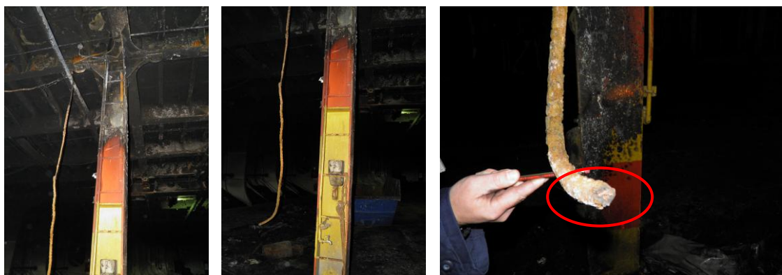
Η πυρμαϊά πλευρά του στύλου μεταξύ των νομέων 219-221 και το κομμένο καλώδιο.
