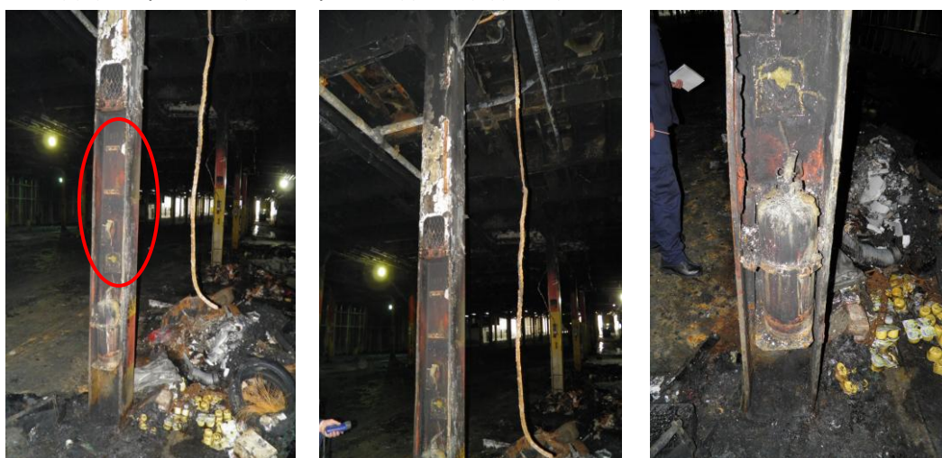
Ο στύλος μεταξύ των νομέων 219-221 ο οποίος εντοπίστηκε με αυξημένους δείκτες καύσης στην πρωραία του πλευρά, η βάση του ρευματοδότη και το κομμένο καλώδιο. Επίσης διακρίνονται τα σημάδια τήξης του υλικού του ρευματοδότη στον πυροσβεστήρα και στο δάπεδο.
